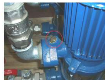
Fig. 6: Montaje del transductor en la rosca del tapón de llenado 1/4" en impulsión
