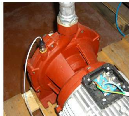
Fig. 3: Montaje del transductor en el tapón de llenado de una bomba monoblock.
